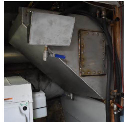
© Caroline Ovia / Fondation Tara Océan Caisse journalière de gasoil de la cale arrière avec jauge de niveau.
