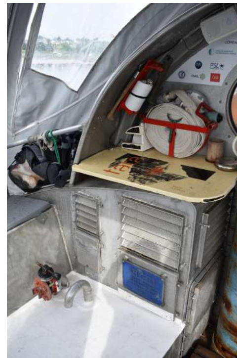
© Caroline Ovia / Fondation Tara Océan Lance à incendie enroulée que l'on vient raccorder à la bouche d'arrivée d'eau de mer (en bas à gauche).
