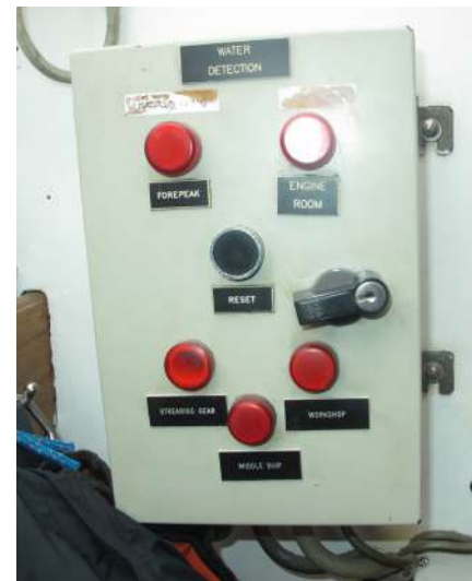
© François Aurat / Fondation Tara Océan Tableau de détection d'eau de TARA. Seule la zone du puit à chaîne n'a pas de détecteur d'eau.
