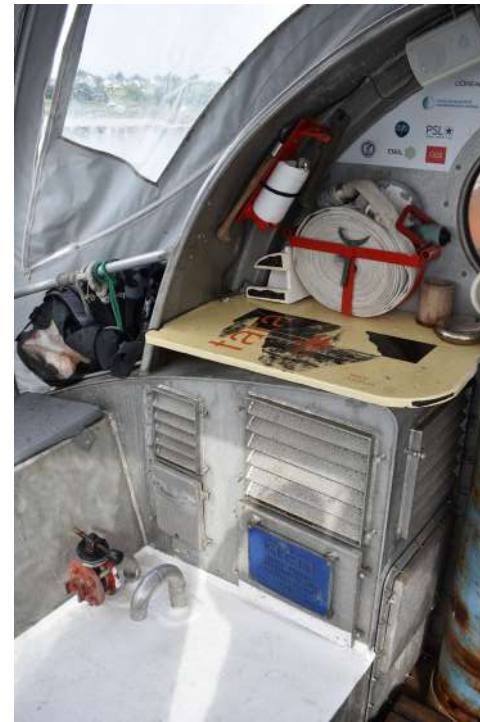
© Caroline Ovia / Fondation Tara Océan Lance à incendie enroulée que l'on vient raccorder à la bouche d'arrivée d'eau de mer (en bas à gauche).
