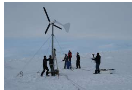
© Grant Redvers / Fondation Tara Océan Éolienne en cours d'installation sur la banquise.
